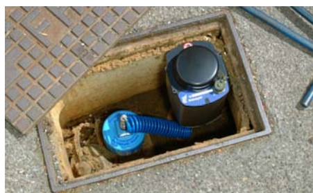
XiLog installert på hydrant i en kum.
